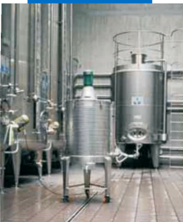
Hình ảnh sàn ở nhà máy rượu được chít mạch bằng Kerapoxy
